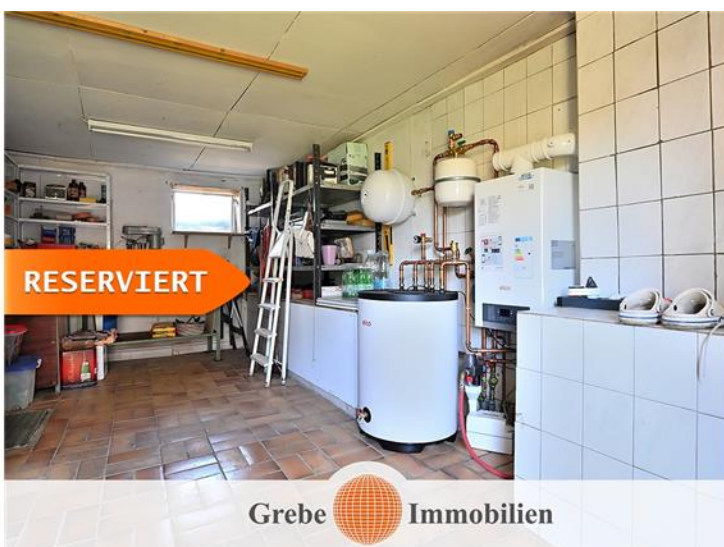
Heizraum neben der Bauernstube
